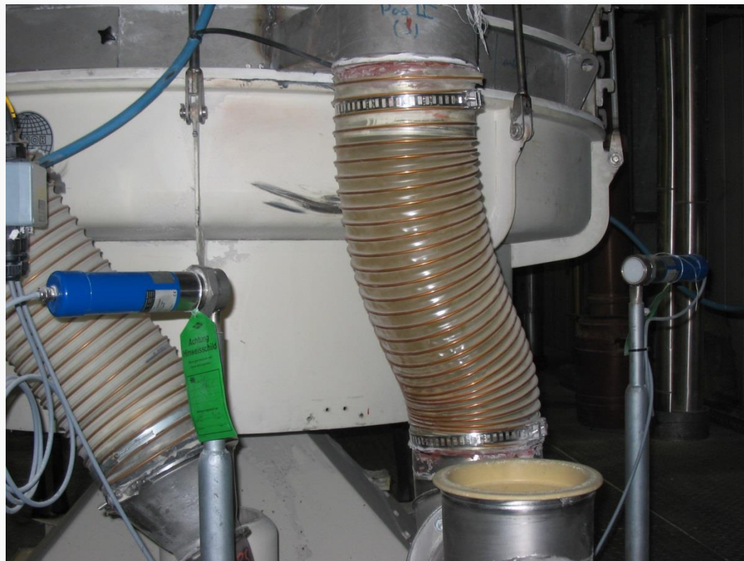
Instalação através de uma mangueira com muita vibração
