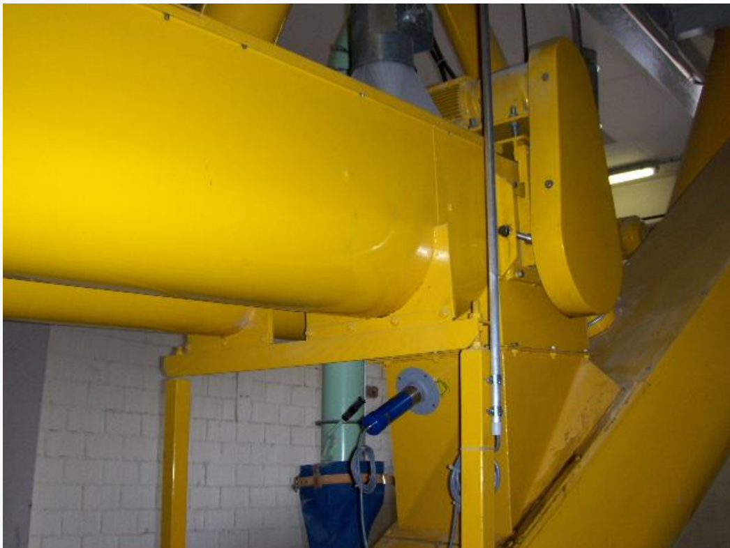
Detecção de ração em queda livre, antes de rosca transportadora (UfA Switzerland)
