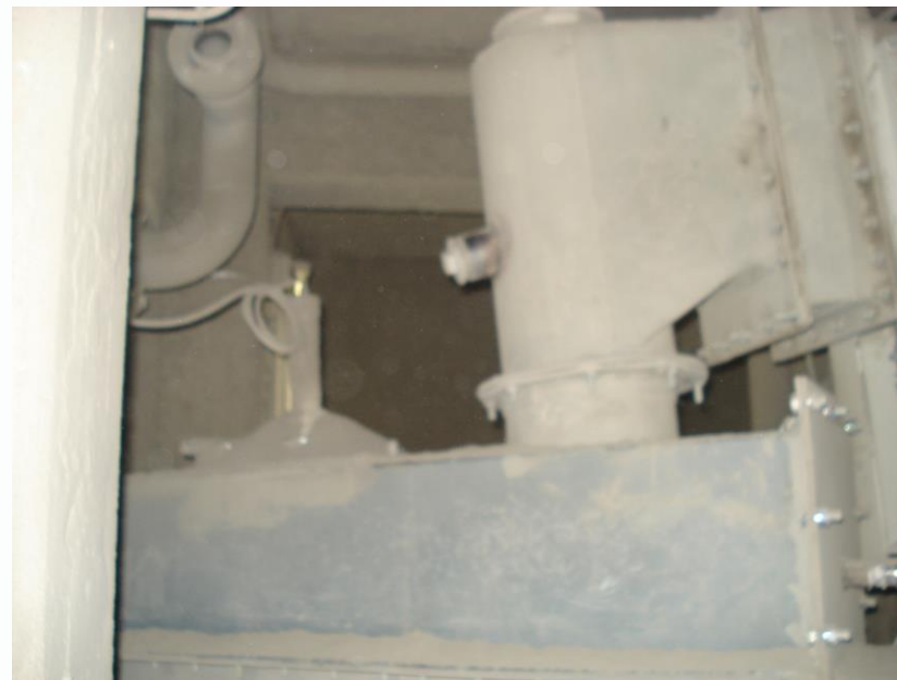
Schwenk Zement 2 sistemas instalados
