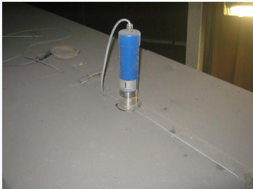
Dillinger Hütte (Siderúrgica) 2 sistemas instalados
